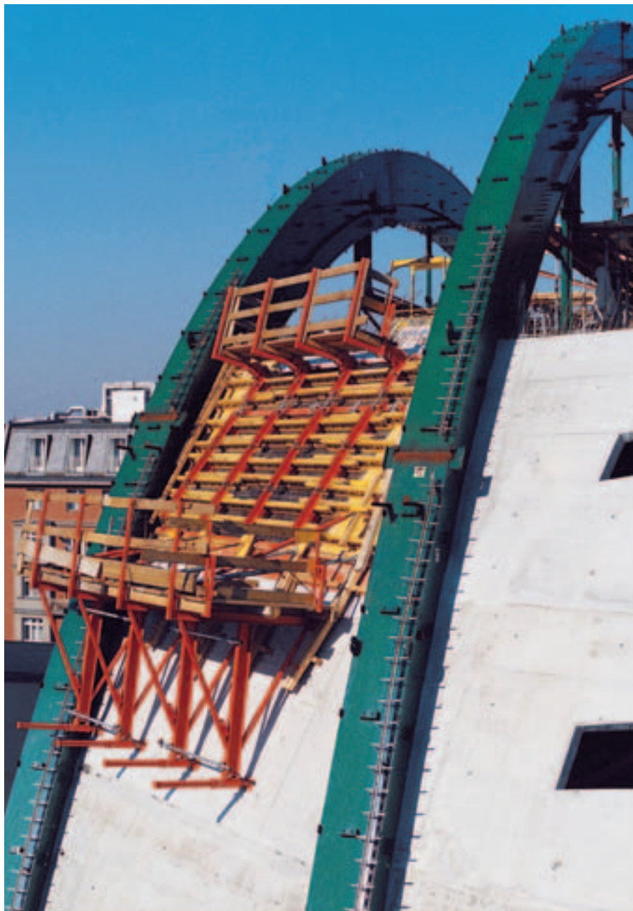
RUNDFLEX "liggende" til forskalling af en hvælving i et kulturhus i Berlin.
