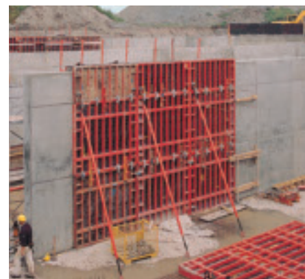
TRIO elementer liggende på siden og montert til en høyde på 6,0 m.
