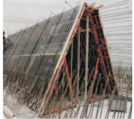
Trapesformet tunnel med TRIO og SKS konsol.
