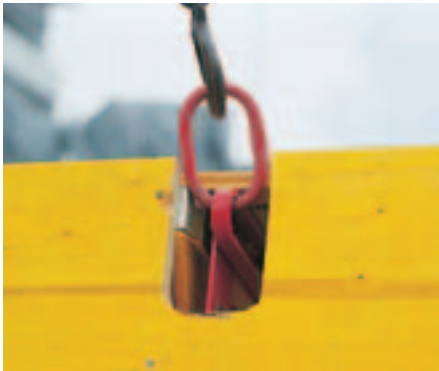
Bildet viser øvre dekklist som beskytter mot betongsøl og den fast monterte krankroken.
